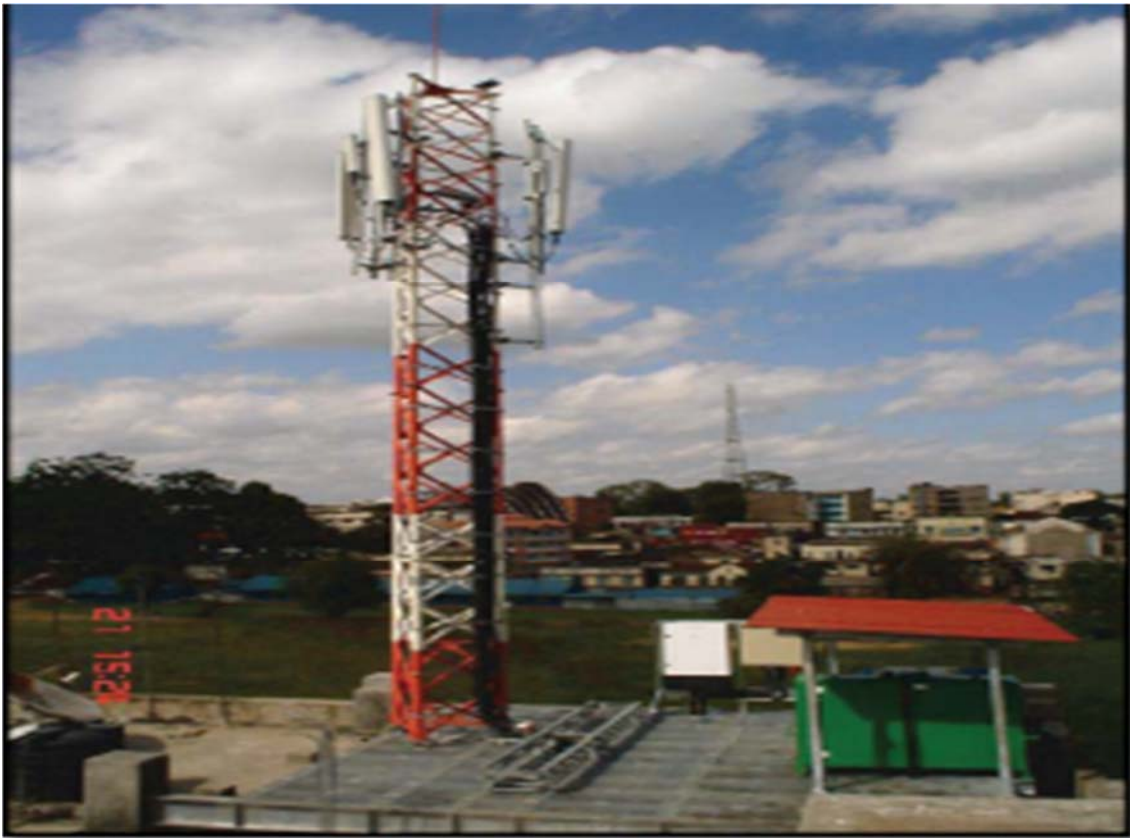
GSM Roof Top Site
